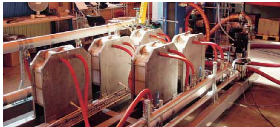
Den fullskaliga demonstrationsanläggningen i Hammarby Sjöstadsvverk kommer att ha en kapacitet på upp till 10 000 liter vatten per dag. (På bilden syns fem av blivande tio moduler).
